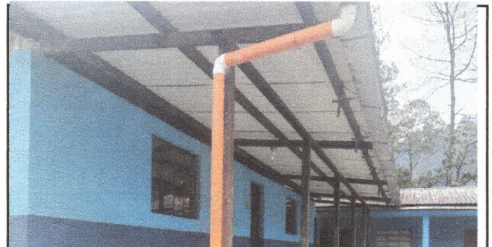
Foto 10: bajadas pluviales en óptimas condiciones, que evita el reposo de agua en el patio de la escuela.
